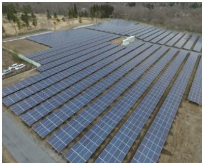
■ 那須太陽光発電所
