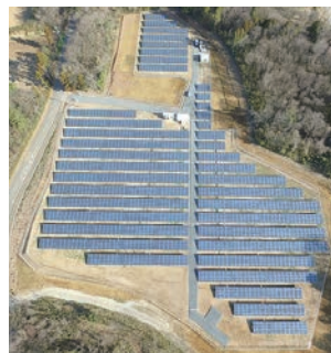
■ 熊谷太陽光発電所 I
