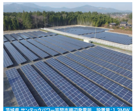
茨城県 サンテックパワー笠間市押辺発電所 設置量:1.3MW
